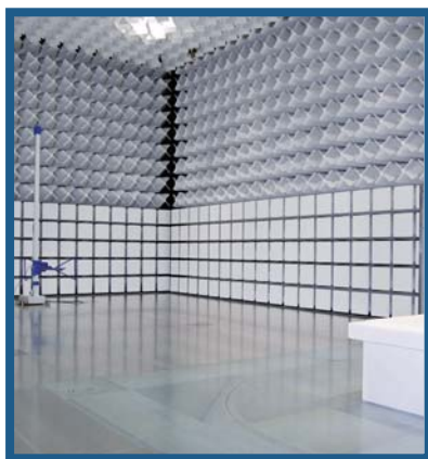
第一電波暗室（10m法）
